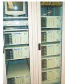
SERVER主機 HP SERVER
